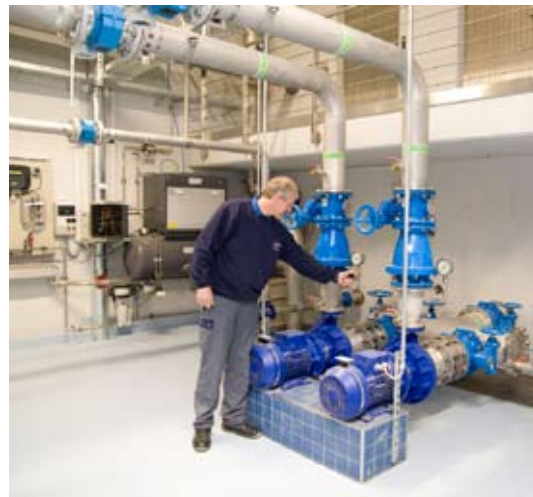
Rohwasserförderpumpen (Foto Reiner Löbe)
